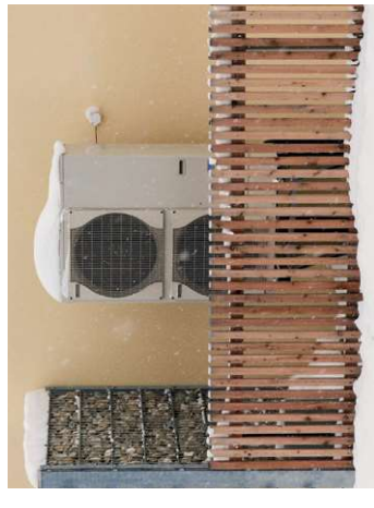
Luft-Wärmepumpe mit Lärmschutz
